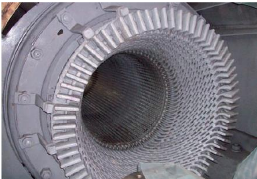
Fot. 1. Stojan generatora po wyjęciu wirnika
