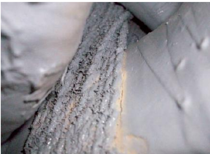
Fot. 2. Skutki wyładowań powierzchniowych
